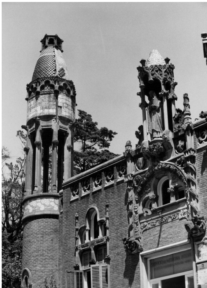
Desperfectos en la fachada del pabellón de Sant Rafael, 1978
